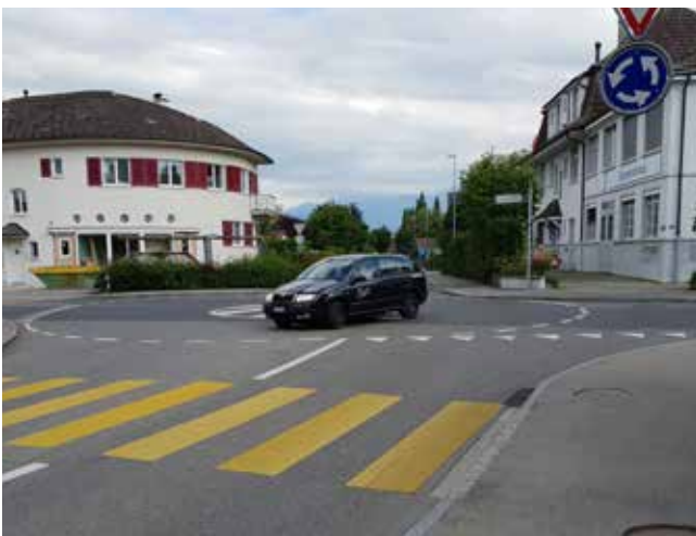
Abb. 3: Minikreisel mit einem zu einfach überfahrbaren Innenring (Mattenstrasse - Länggasse in Thun, Sanierungsprojekt durch B+S AG in Erarbeitung).
