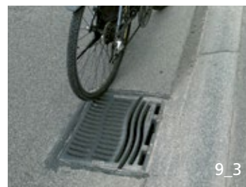
Velofreundlicher Einlaufschacht (Ipsach)
