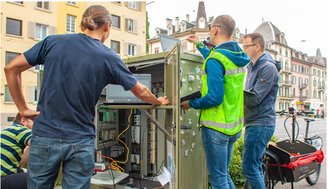
Erst-Inbetriebnahme der Selbst-Steuerung
