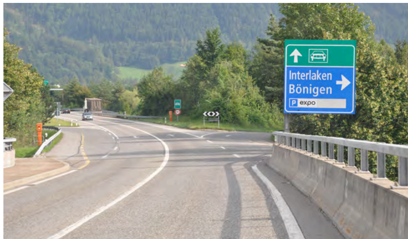
Nahtloser Übergang ohne Fahrbahnquerung (schlechte Ausführung, vgl. s. 11).
