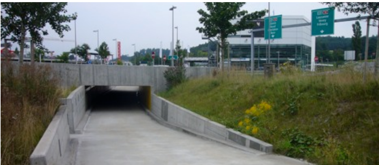
Pas de traversée à niveau de la RGD, franchissement dénivelé (passage inférieur).
