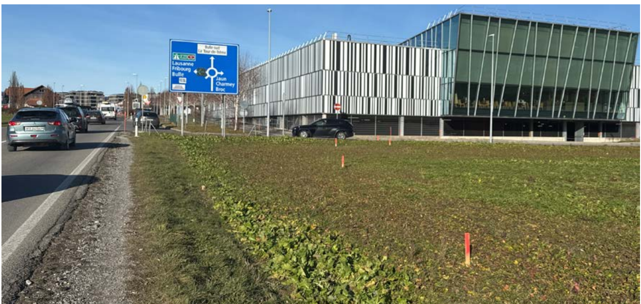
Absteckung einer geplanten Mischverkehrsfläche für den Fuss- und Veloverkehr in La Tour-de-Trême (Quelle: TBA, P. Rime)
