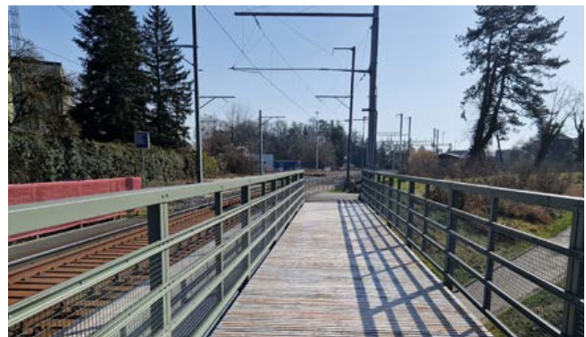
Der Emmesteg ist bereits in Betrieb, die Gemeinde Biberist konnte die Verbreiterung als Ersatzmassnahme ins Agglomerationsprogramm der 2. Generation einreichen. (Foto: Linus Heini)
